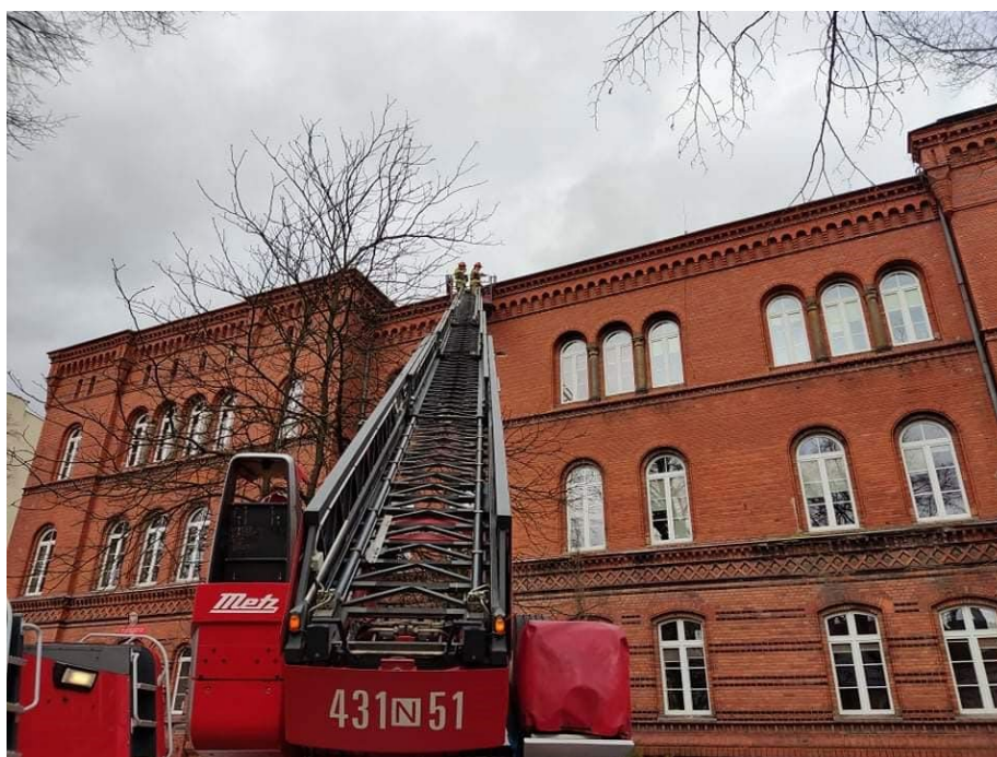
Rysunek 13. Interwencja Straży Pożarnej w Elku spowodowana uszkodzeniem dachu przez silne porywy wiatru (źródło KPPSP w Elku)
